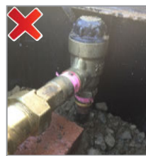
PRV in box
